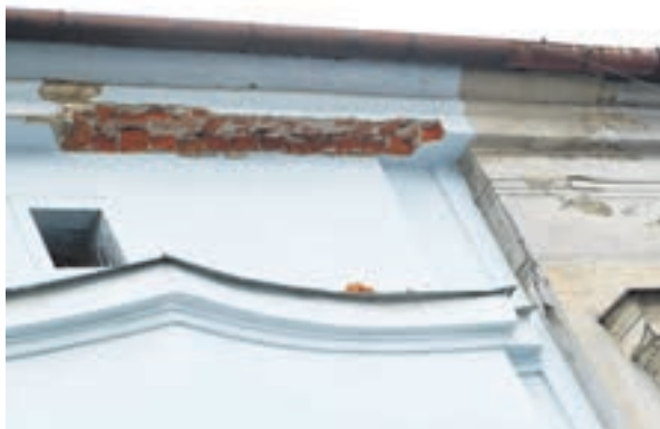
Takhle dopadly fasády některých domů v centru Karviné po nedávném silném otřesu.
